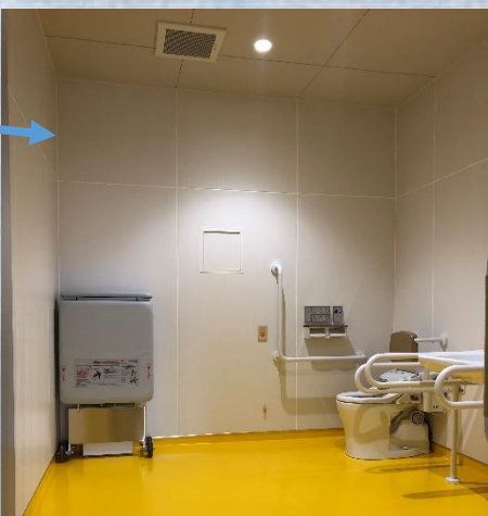
↑【多目的トイレ】 各フロアに設置され、車いすでも 利用できます。
